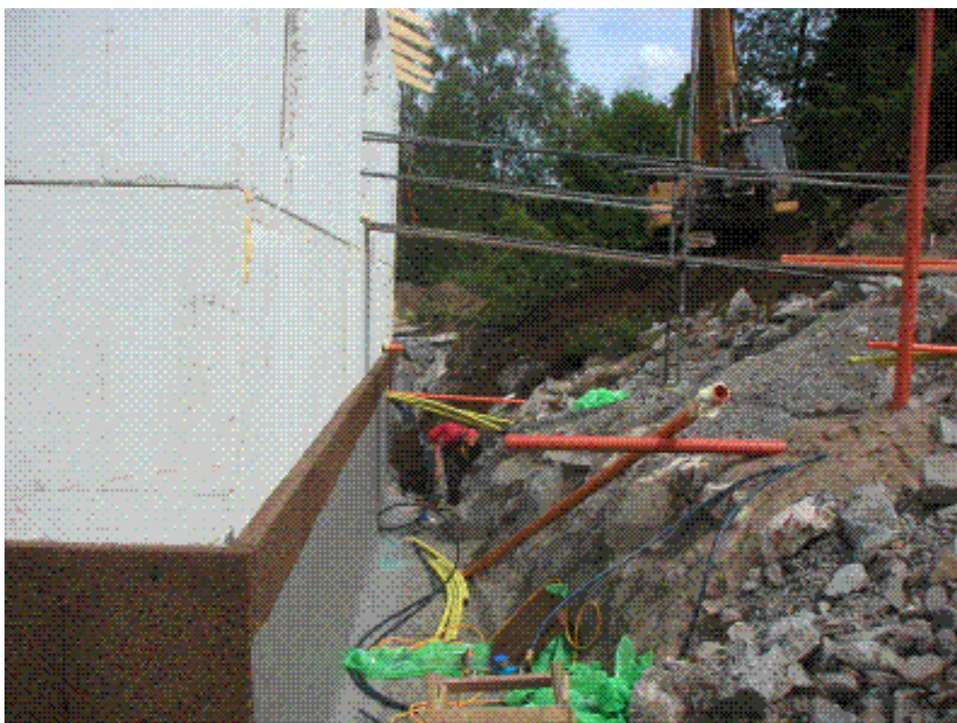
Lägg märke till att servis och el leds in i huset genom källarväggen
